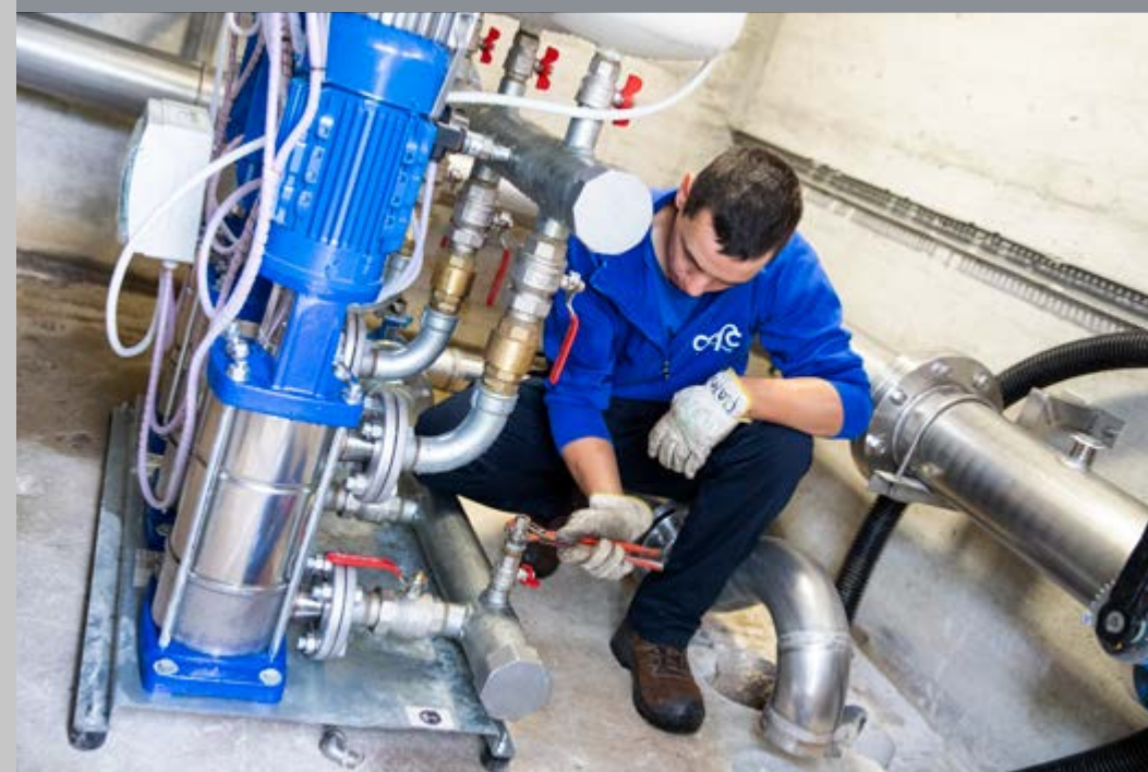
Impianto di pressurizzazione e disinfezione Cervignano del Friuli (Ud)
