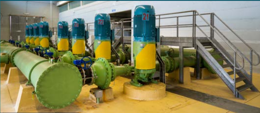
Impianto di sollevamento Molino del Bosso, Artegna (Ud)
